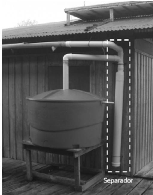
FIGURA 6.7: Separador de Água de Primeira Chuva da Pousada Uacari.
