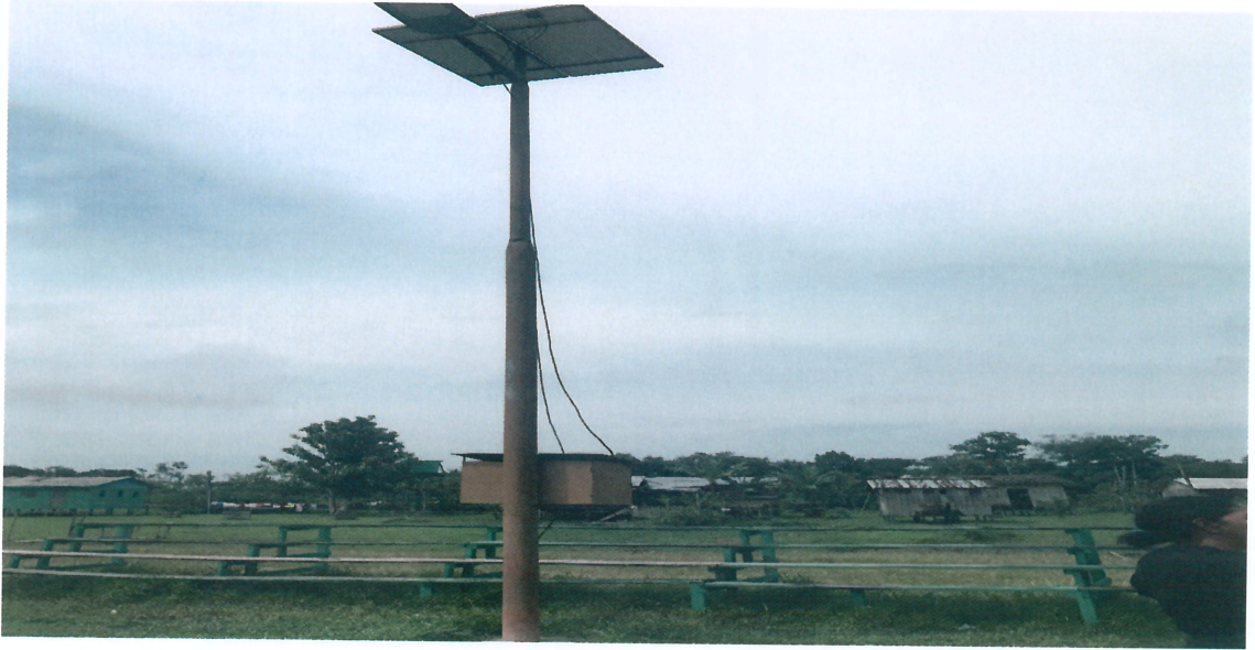
Vila Nova do Amanã (Reserva de Desenvolvimento Sustentável de Amanã): Instalação elétrica para a iluminação do campo de futebol (projetos de tecnologias sociais), alimentada com energia solar.
